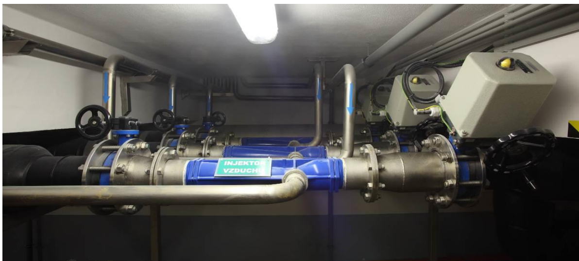
Obr. 1. Provozní aplikace injektorů na ÚV Hajská
